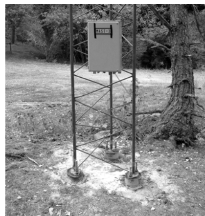
Ordentligt markjobb med bergsfäste. Låda med anslutningar, plats för koaxrelän etc.
